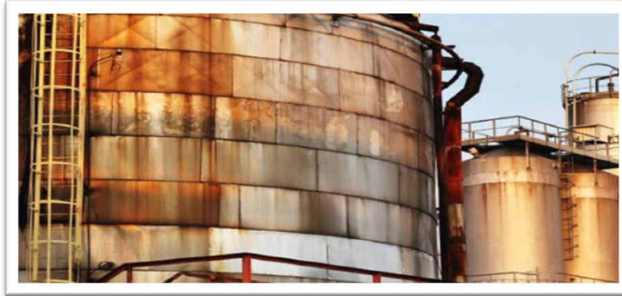
Destrucción de estructuras de acero y materiales metálicos en la industria
